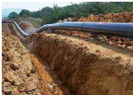
Assenza di protezioni
