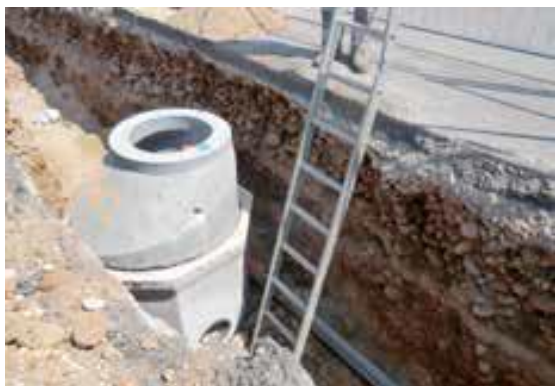
Assenza di protezioni
